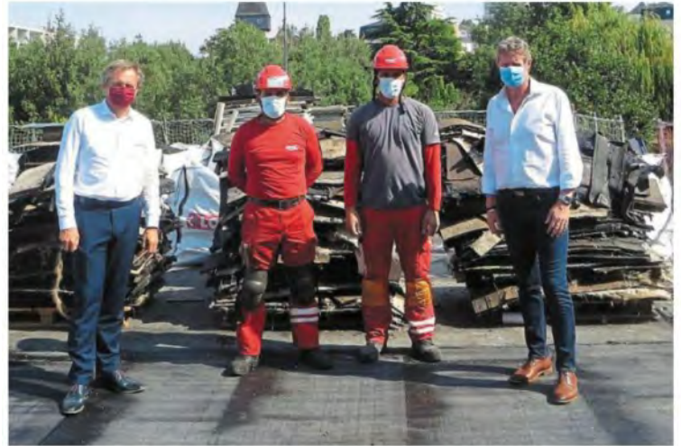
Christophe Rouillon, maire, et Jean-François Alisse entourent les deux ouvriers qui isolent le toit de la mairie. PHOTO : OUEST-FRANCE
